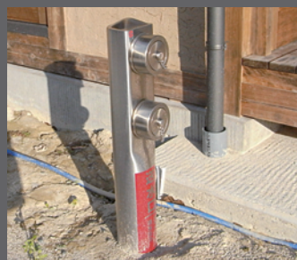
敷地内に設けられた送水口
