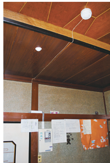
居間壁の火災報知器で出火場所確認 天井にSPヘッドと火災感知器
