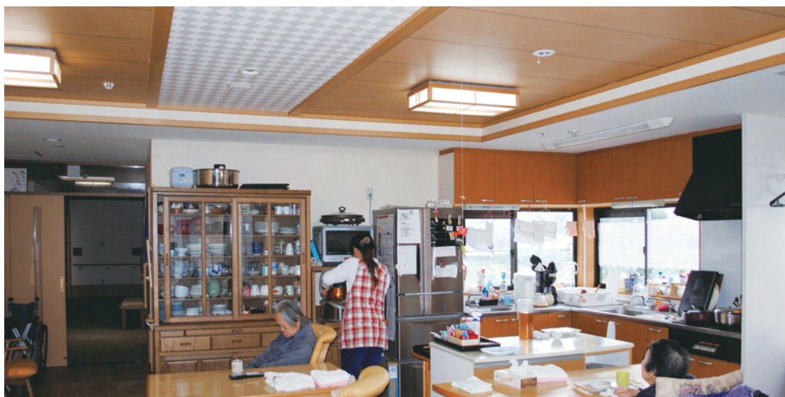
リビング天井部分に取り付けられたスプリンクラーヘッド
