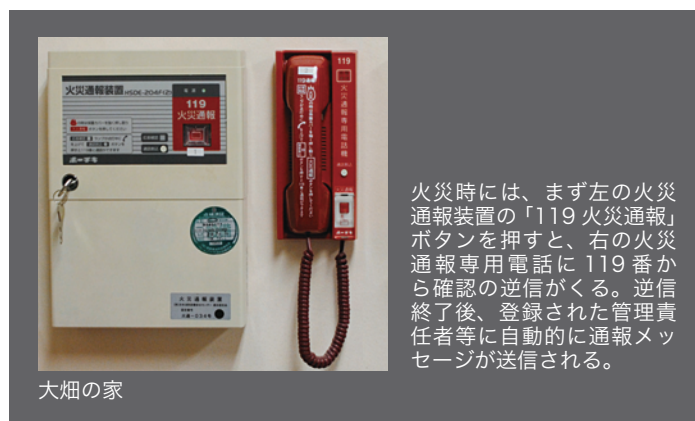
図表 4-8 消防機関へ通報する火災報知設備
