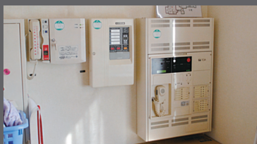
2ユニットのつなぎ部分にある各種消防設備
