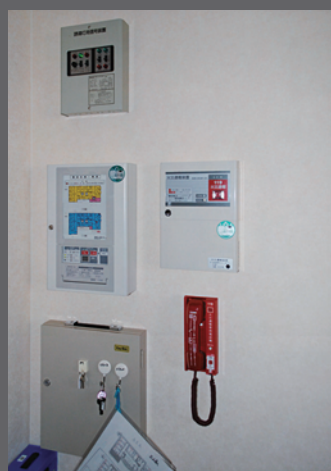
事務室にある火災通報装置（登録した4名に順次連絡可能）
