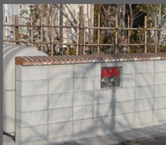
境界壁に設けられた送水口
