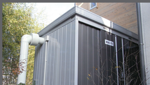
小規模特養脇に設けられた SP の加圧送水装置
