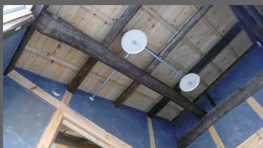
天井面が高いため集熱板を設けた SP ヘッド
