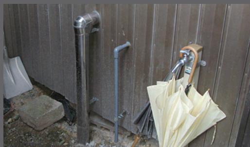
水道から SP への引き込み配管
