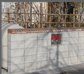
境界壁に設けられた送水口
