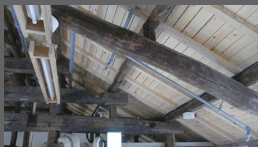
配管の露出型方式を採用したリビング天井面
