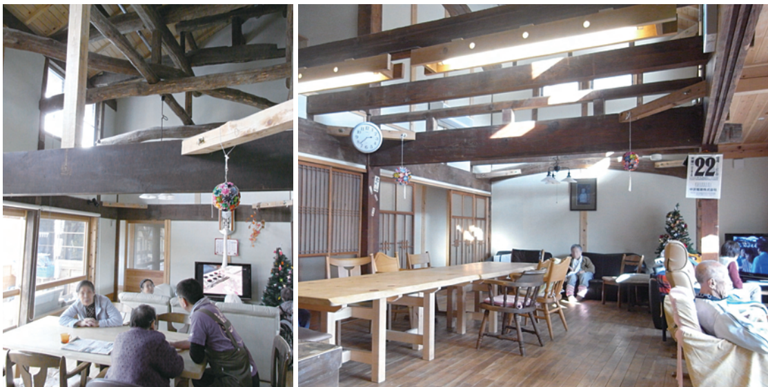
リビングの様子：民家の古材を活用し、耐震性を確保しながら新築型としてよみがえらせた事例
