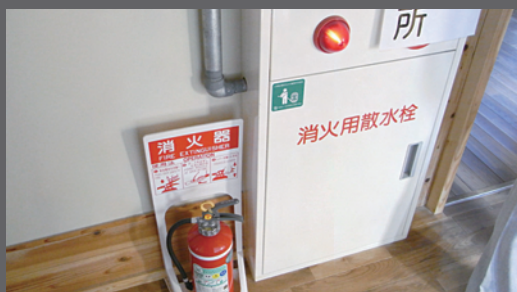
GH 内に設けられた消火器および消火栓
