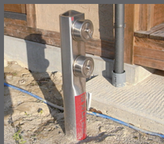
敷地内に設けられた送水口
