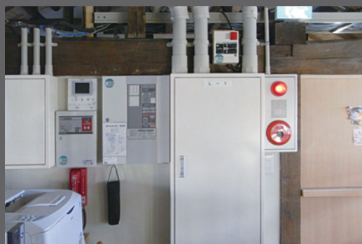
消防機関に通報する火災報知設備（2階事務室）
