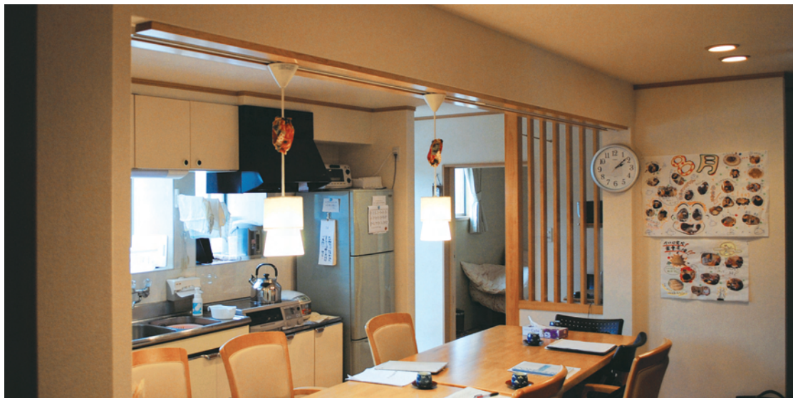
耐震補強工事により新たに付け加えられた柱と梁（時計がかかっているのが柱）
