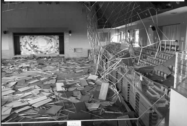
参考: 想定していなかった被害で使用不能
