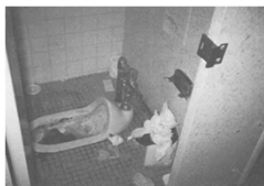
学校のトイレ (阪神淡路大震災 1) )
