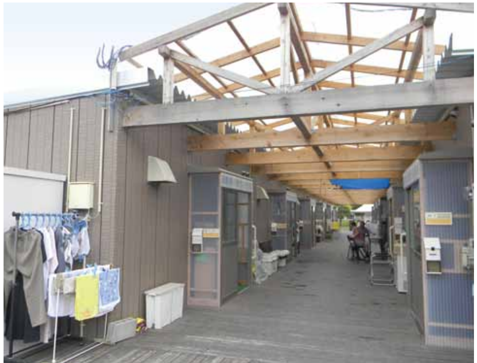
釜石市平田地区サポートセンターの仮設住宅。 高齢者棟はデッキが敷きつめられ、隣近所の交流の場に。また、雨の日も洗濯物が干せるようになっている。
