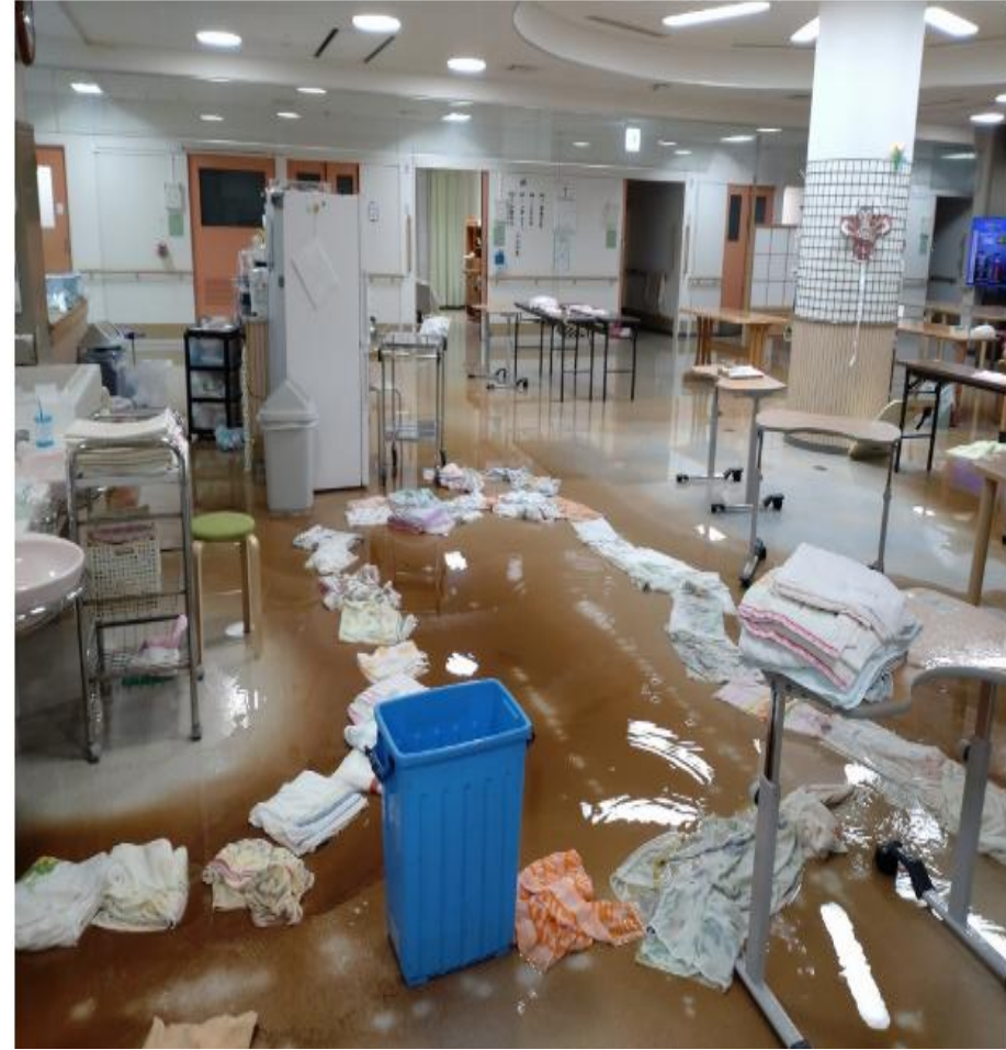
水道管が破裂し、フロア水浸し
