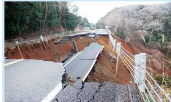
県内各地で道路が崩落し、奥能登への アクセスルートが遮断
