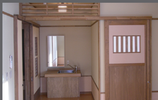
個別温水器を設置した個室内洗面流し
